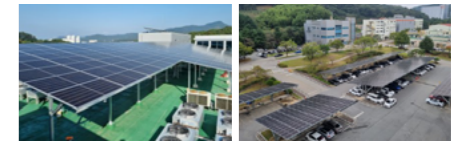
대덕 DC 내 태양광 발전설비 설치 현황
